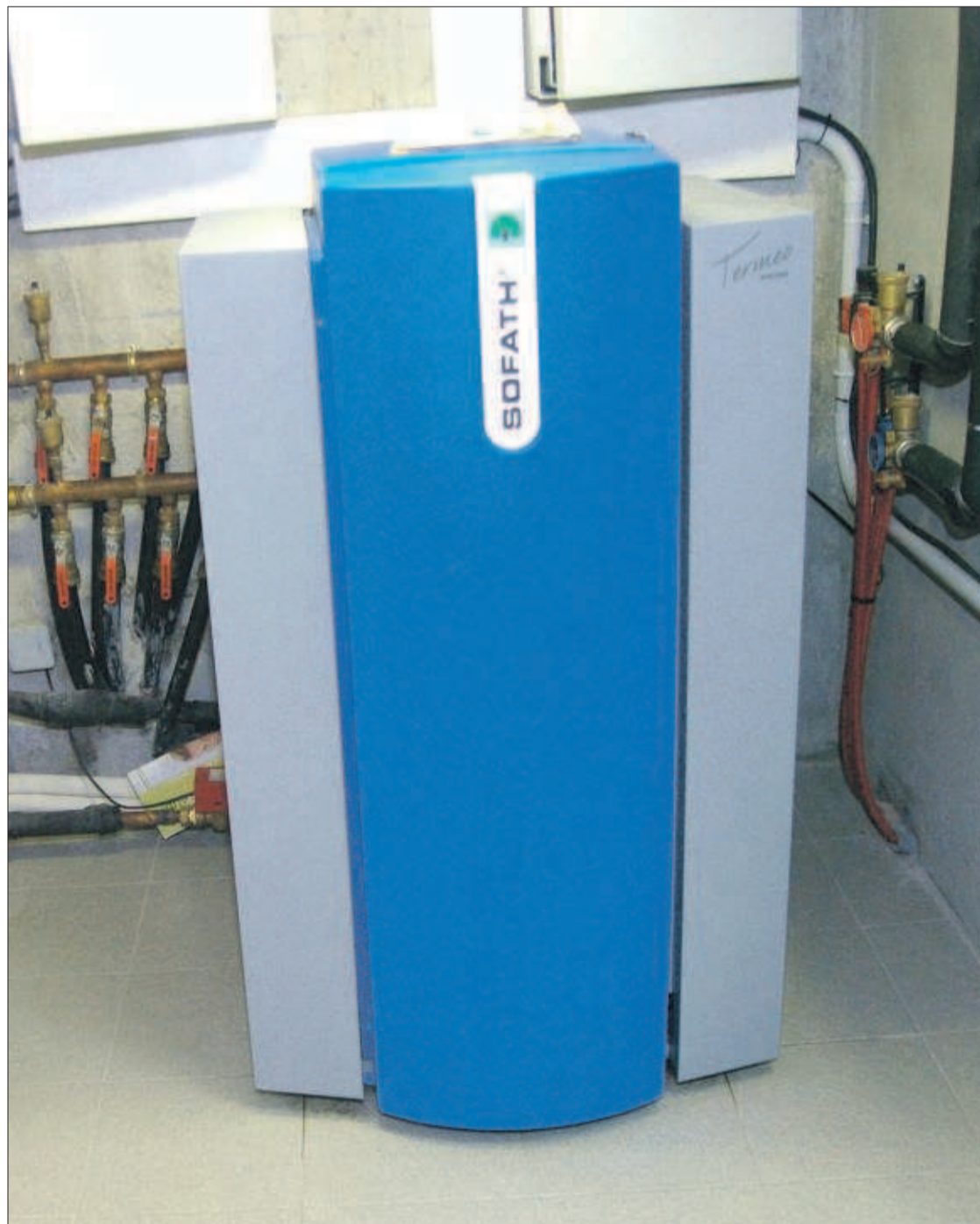
Una instal·lació de geotèrmia en un habitatge del Principat.
