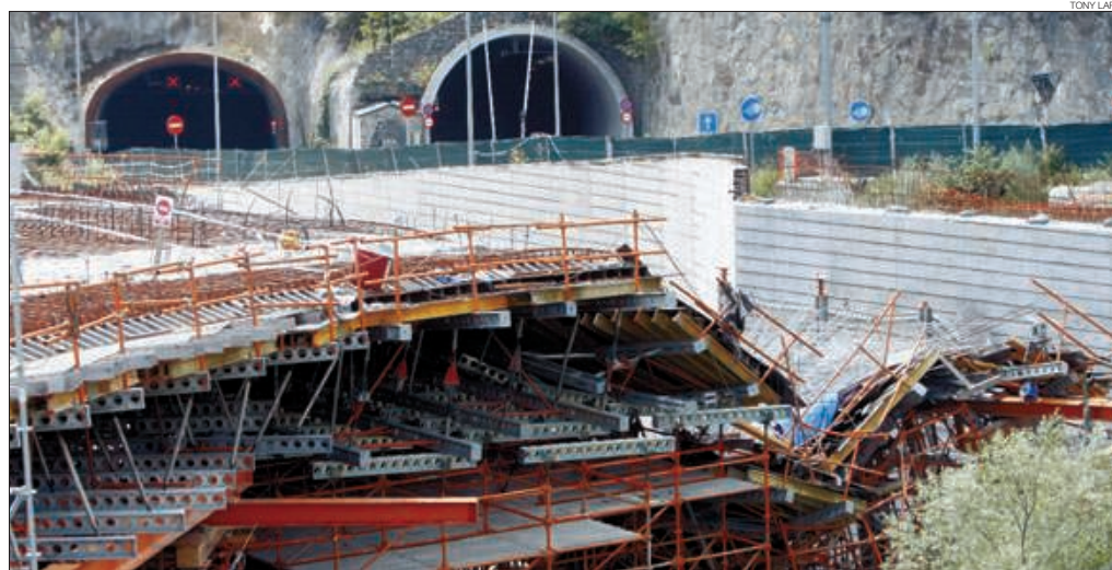
► La zona de l'estructura E-2 on va tenir lloc el sinistre mortal el mes de novembre passat, ahir.
