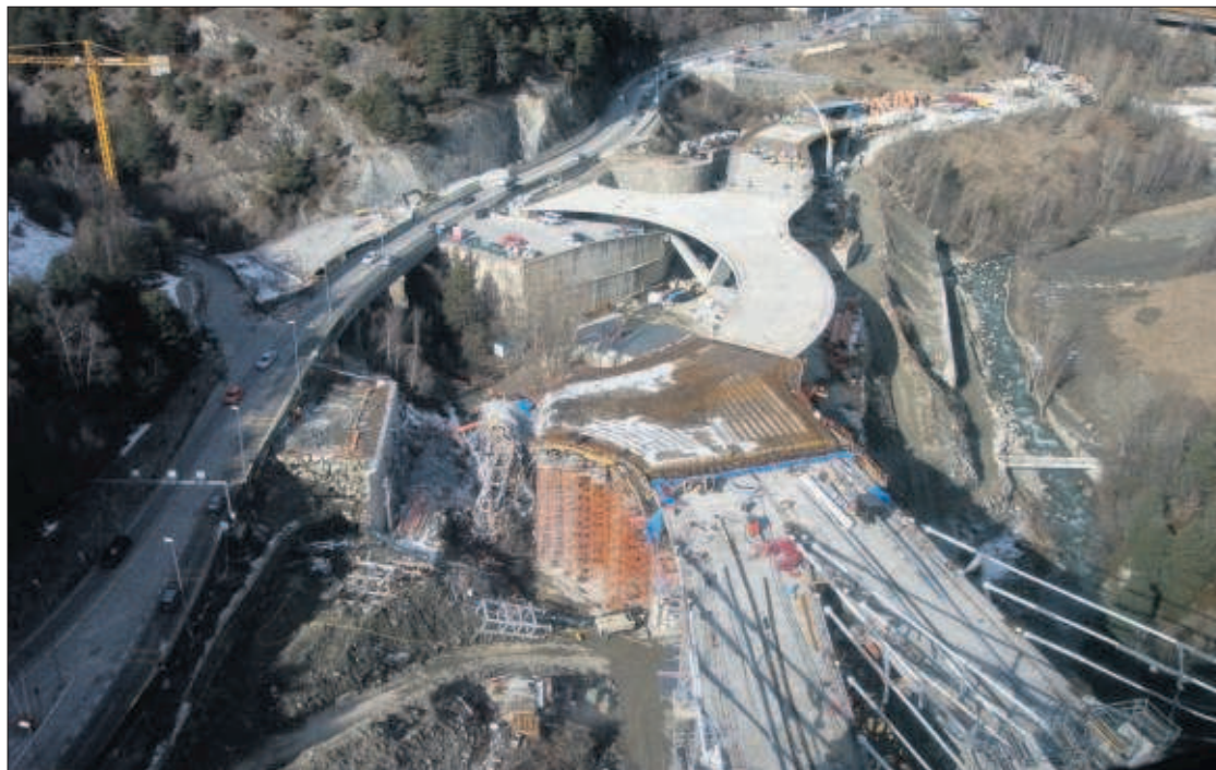
Vista general de les obres a la boca oest del túnel dels Dos Vallres.
