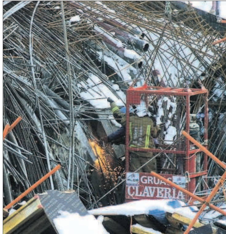
Els bombers treballen al viaducte després de l'accident. FERNANDO GALINDO
