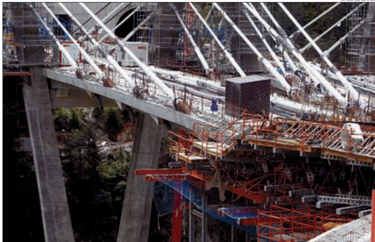
► Part de l'estructura del vial del túnel dels Dos Valires a la boca oest, afectada al maig.
