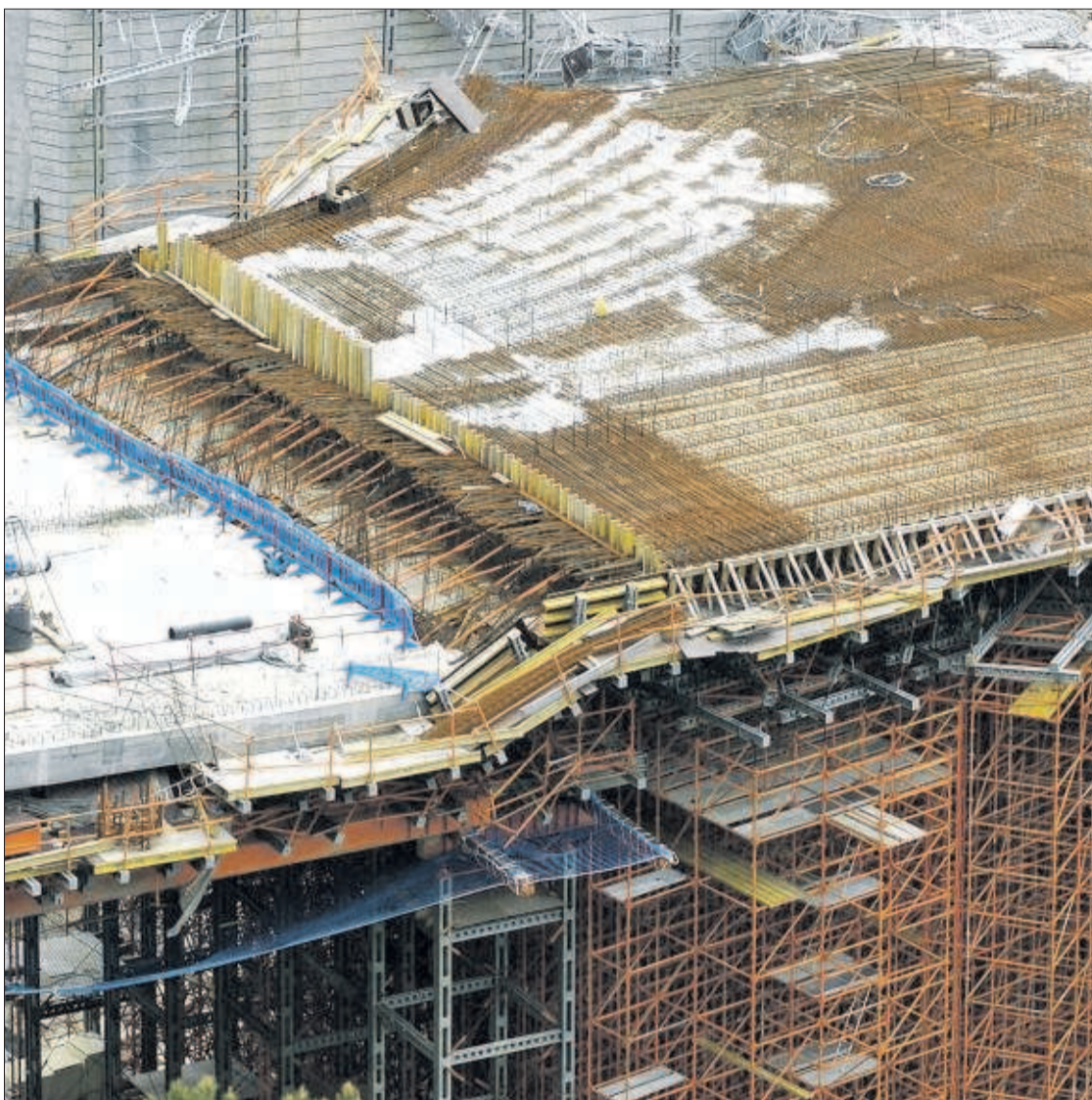
Imatge de la part del viaducte on va tenir lloc el segon esfondrament.
