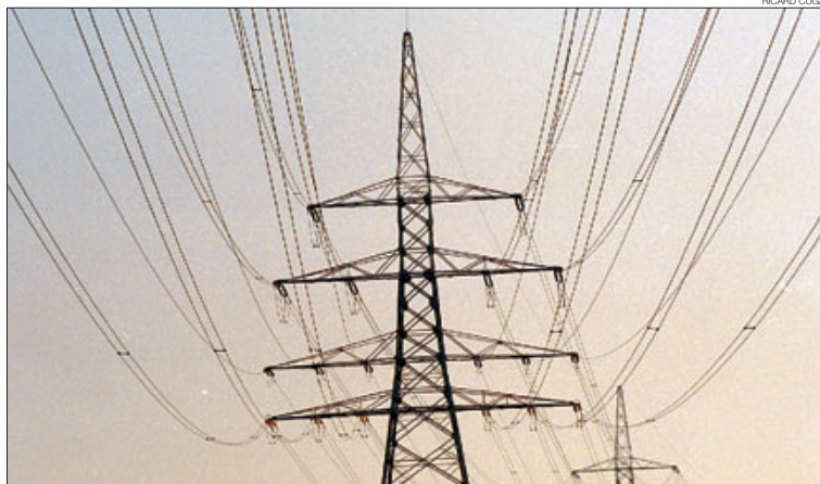
► Vista d'un circuit de torres exteriors d'electricitat.
