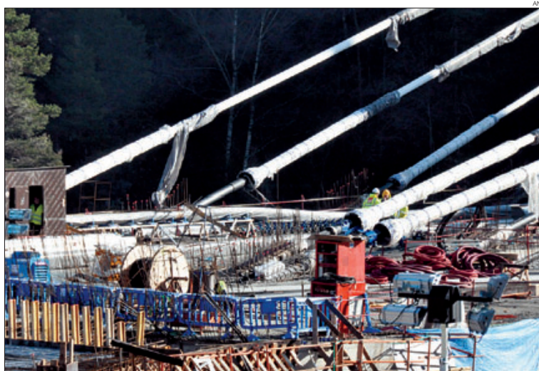
► Els obrers inicien els treballs de consolidació a la boca oest del Dos Valires, ahir.
