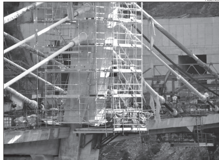
Els operaris del túnel dels Dos Valires, ahir, treballant a la infraestructura.
