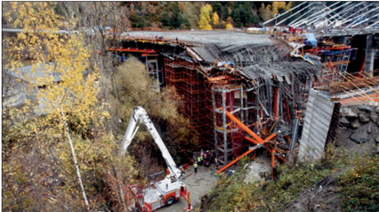
► Una imatge de l'estructura del túnel del Dos Valires que es va esfondrar.
