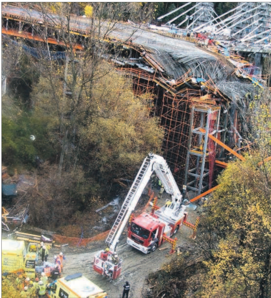
Vista de l'estat de l'obra poc després de l'accident, el 7 de novembre.
