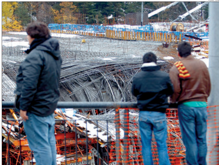
► Uns ciutadans observen l'estructura destruïda del túnel, ahir.
